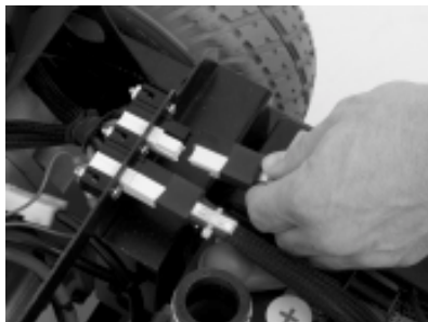
Figure 15. Connecteurs des batteries
